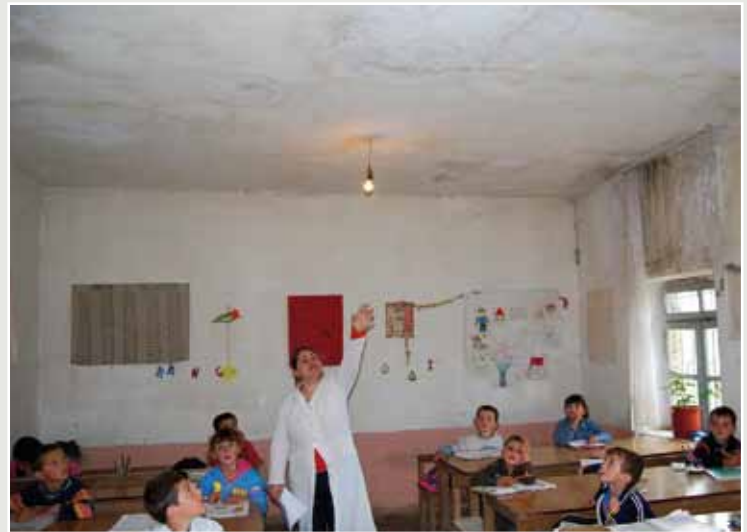
Banger Blick zur Zimmerdecke: Wenn es regnet, tropft das Wasser auf die Tische.
