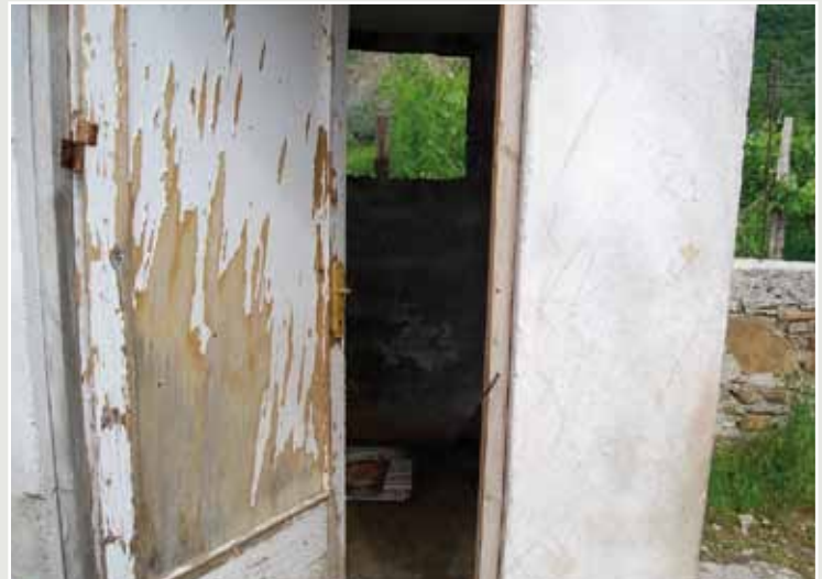
Die Toiletten sind häufig kaputt – ein Albtraum.
